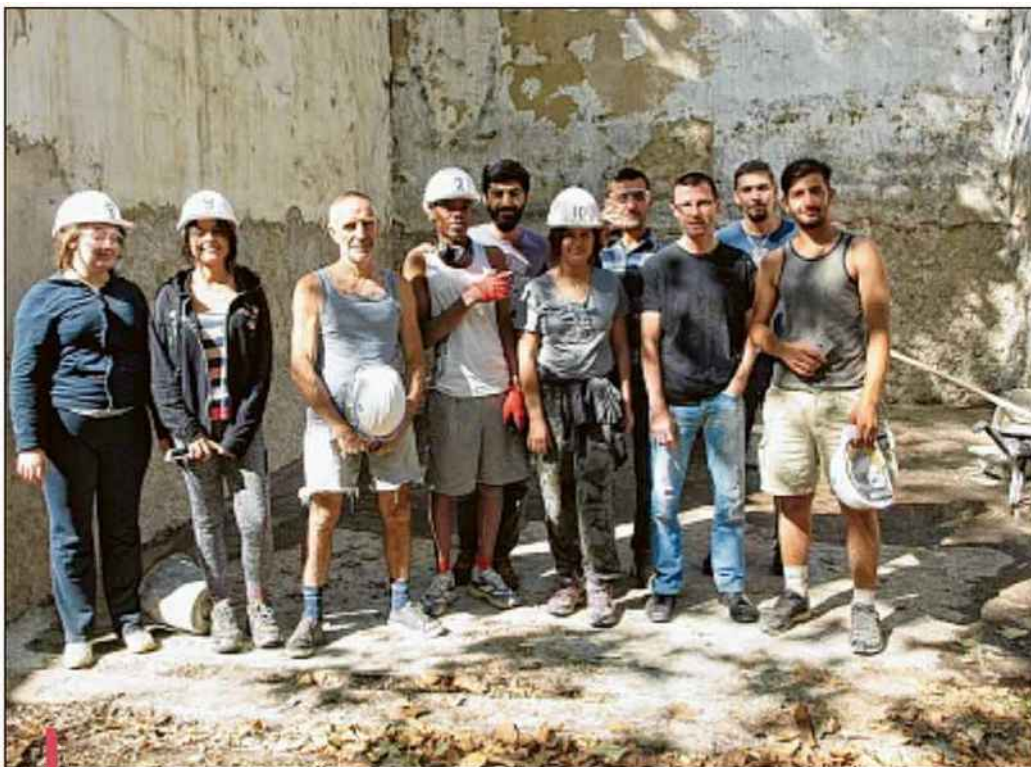
Le groupe, enthousiaste et bien équipé va refaire les enduits du moulin.
