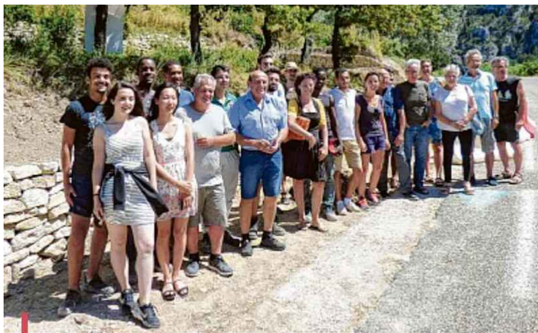
Venus du monde entier, les jeunes du chantier de l'Apere ont eu besoin de six semaines pour restaurer le mur en pierre sèche qui débute le chemin des Gypières.
